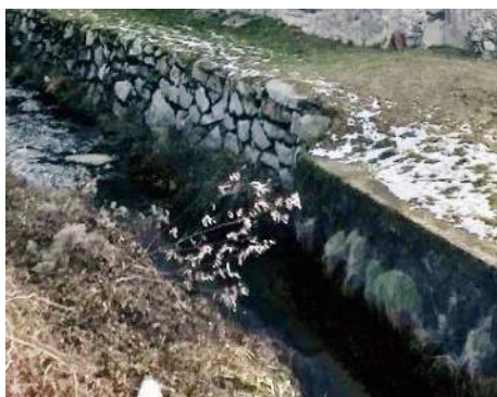
Due diversi muri di sponda accostati, uno in massicciata l'altro in cemento.
